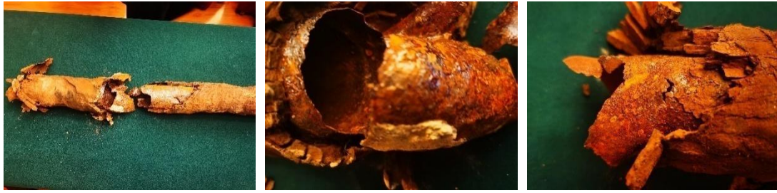
图9 事故管道腐蚀断裂实物
